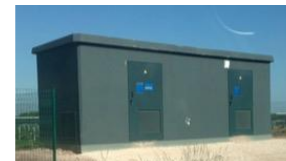
Exemple de poste de livraison (source : NEOEN)
