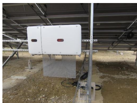
Exemple d'onduleur décentralisé (source : NEOEN)
