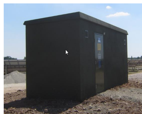
Exemple de poste de conversion « indoor » (source : NEOEN)
